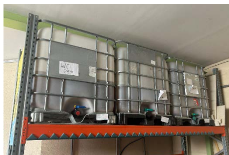
Figure 2 - Cuve collectant les urines des toilettes à séparation et de l'urinoir de Label Verte
