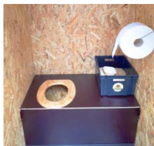
Figure 2 - Toilette sèche, intérieur des cabines (crédit : : ecosmose.fr)
