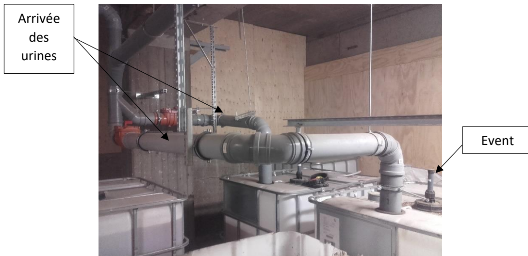
Figure 9 : Cuve de collecte à Tampere (Finlande) site de Kiivamo
