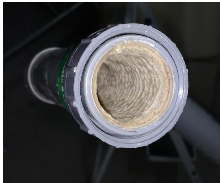
Figure 5 : Dépôt dans un PVC Ø 40 mm avec une pente de 4 % en deux ans de fonctionnement
